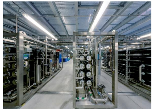
Cofely Services – Pôle Utilités Services / MINATEC Production des fluides process
